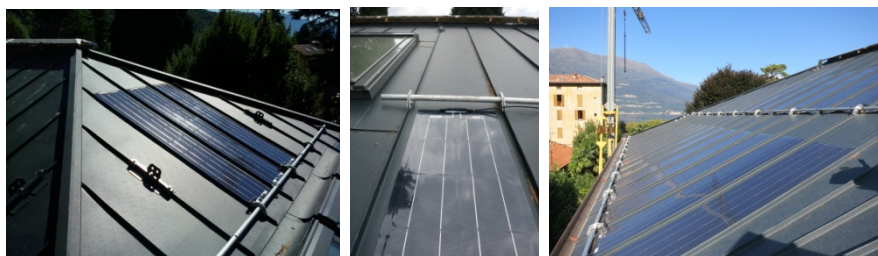
Figura 7 - Dettaglio della copertura e del pannello fotovoltaico (© Myriam Perna e Valentina Cari)
